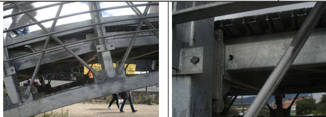
Acabado irregular, de manera localizada, en algunos tramos de la estructura
